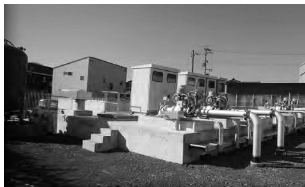
△ 茶町水源地送水施設
