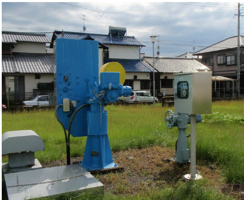
泉町配水場 緊急遮断弁
