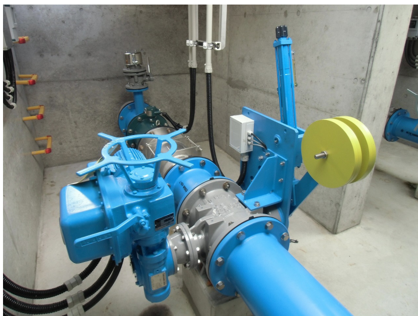
志太配水場 緊急遮断弁
