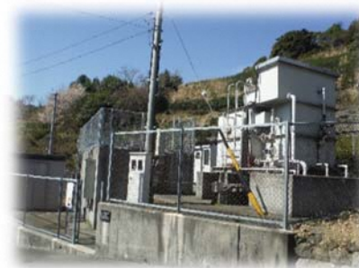
青羽根飲料水供給施設
