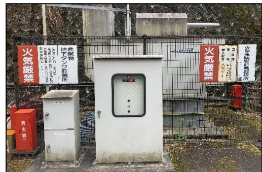
非常用発電機 イメージ
