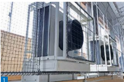
1 キャットウォーク上に床置き設置
