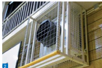
2 キャットウォーク下に吊下げ設置
