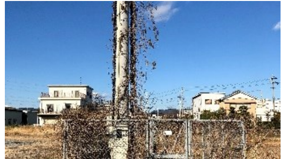
④携帯電話電波塔
