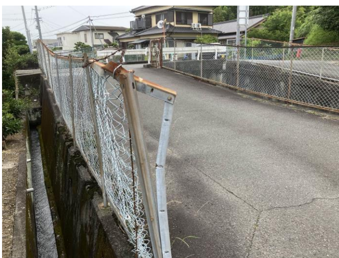
＜内瀬戸695＞ 曲がり角のフェンスが突き出ている。
