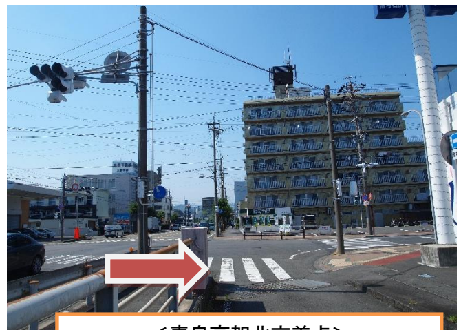
＜青島高架北交差点＞ 2段階で直進するべきであるが、わかりにくく危険である。
