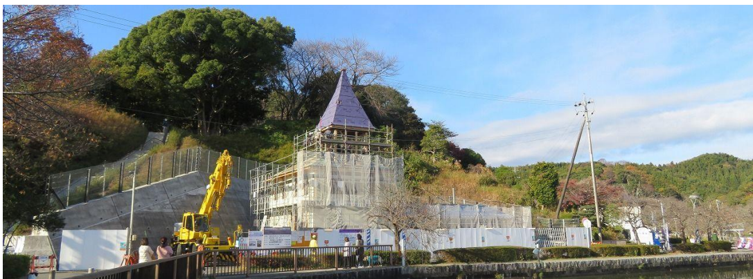
蓮華寺池公園／工事中の旧藤枝製茶貿易商館（通称とんがり屋根）
