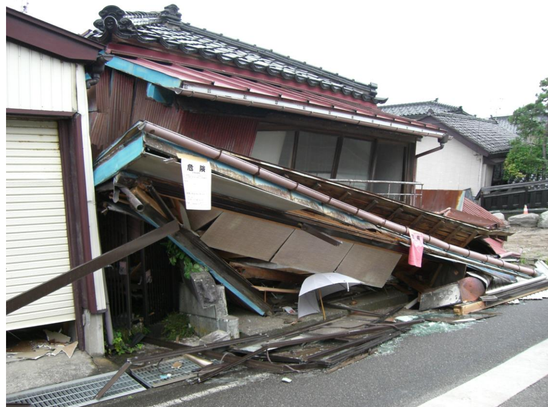
地震で倒壊した家屋
