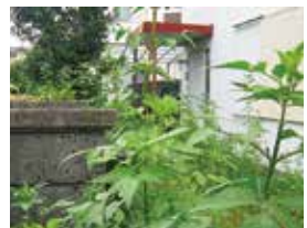
空き家の現状
