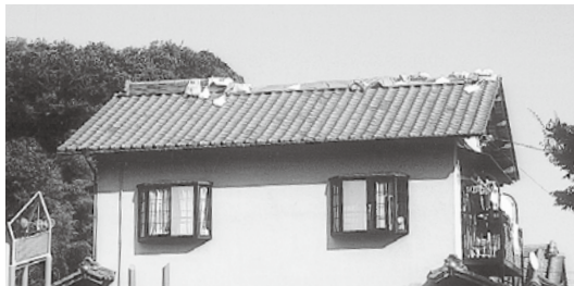
棟瓦の落下した家屋
