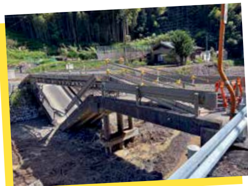
▲市道8地区168号線押越橋の被害の様子
