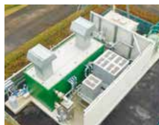
藤枝市浄化センター 消化ガス発電設備写真
