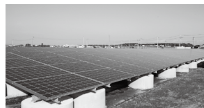
志太広域事務組合で設置した太陽光発電
