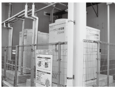
バイオガス発電機
