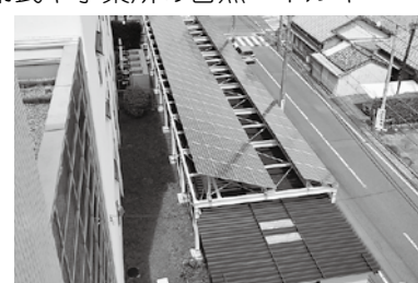
市役所南側駐輪場に設置した太陽光パネル
