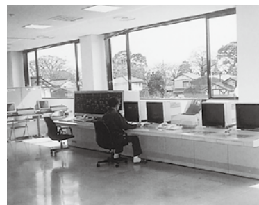
水道庁舎2階の集中監視制御室
