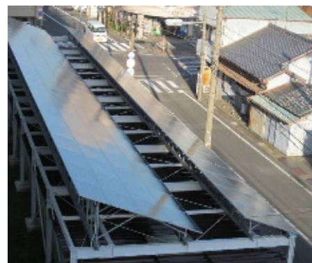
太陽光発電システム（藤枝市役所）
