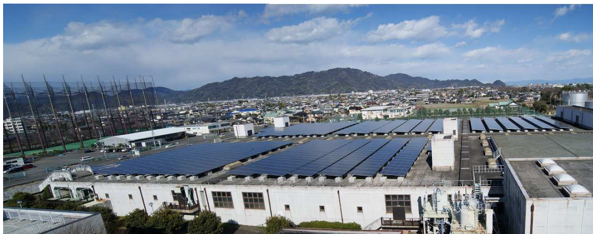
屋根貸し事業により設置された太陽光発電設備（浄化センター）
