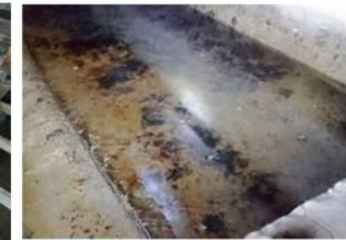
水が残って悪臭が発生する
