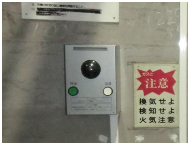
＜入溝監視システム＞ （遠隔監視カメラ・施錠開錠装置）
