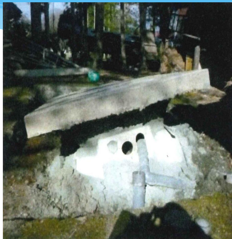
液状化による本体の浮上及び破損
