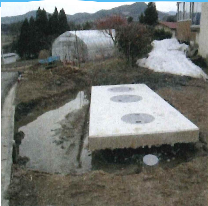
周辺地盤沈下による配管の露出
