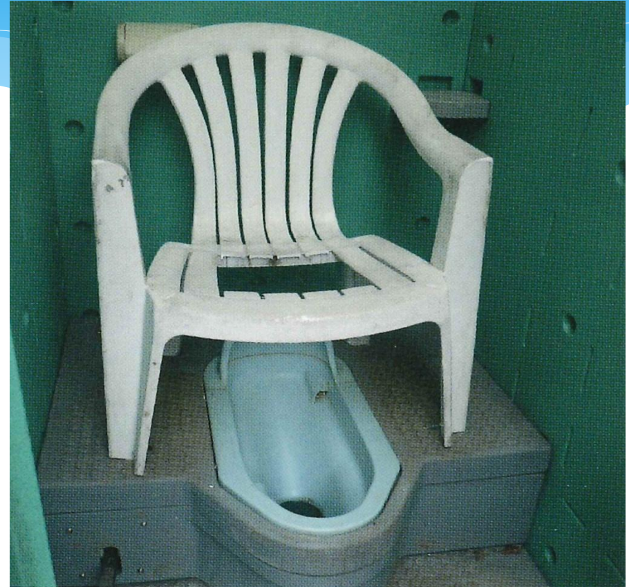
固定型簡易トイレを工夫した便座
