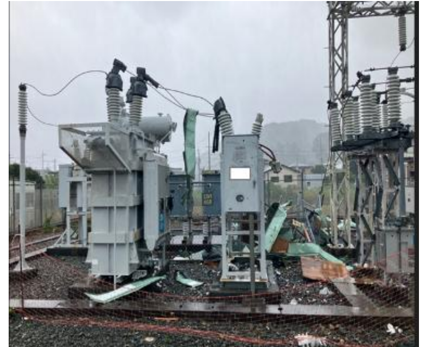
＜変電所の損傷＞
