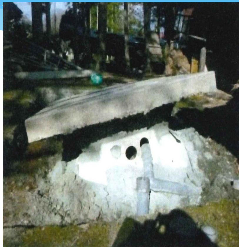
液状化による本体の浮上及び破損
