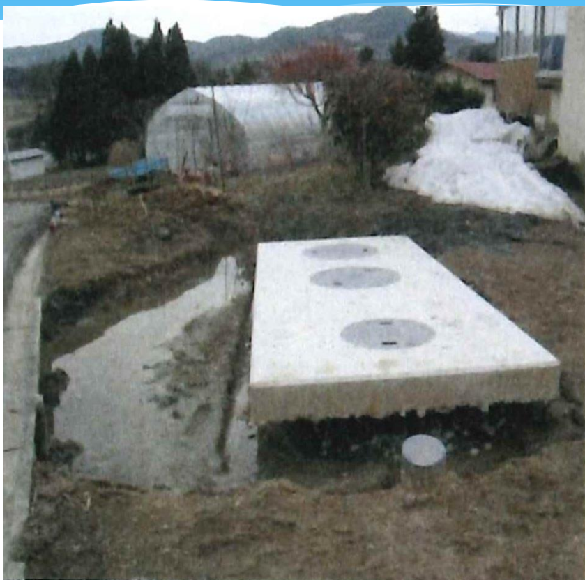
周辺地盤沈下による配管の露出
