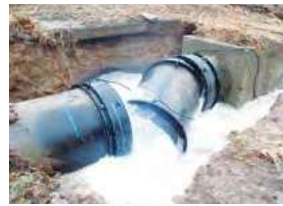
▶東日本大震災による大口径管の継手離脱 (写真提供：宮城県企業局)
