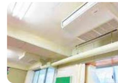
普通教室のエアコン
