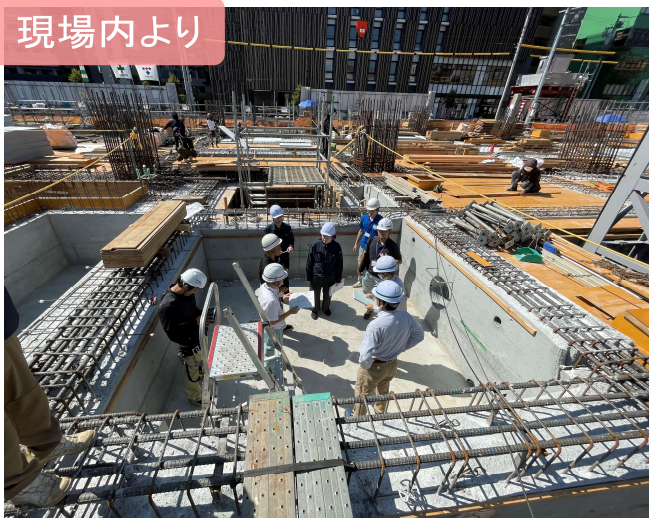
敷地内の雨水を一時的に貯める雨水貯留槽
