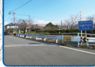
川の柵が少し錆びている隙間も空いているので小さな子が危険
