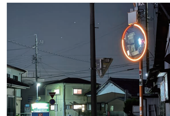
デジタル技術を活用した「多機能カーブミラー」
